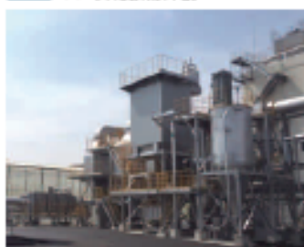
Fig.1 CO 2 供給設備外観
