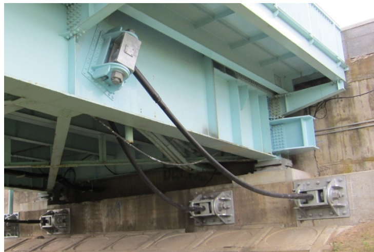
ピン定着落橋防止装置の設置事例
