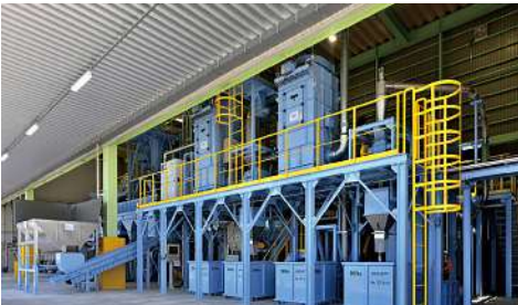
自社オリジナルのリサイクルプラント
