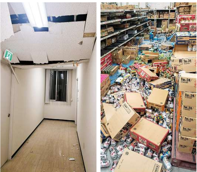
常温商品の物流拠点となっている倉庫の商品落下・天井崩落
