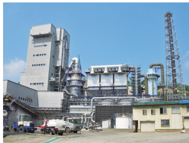
◀小坂製錬のリサイクル対応炉
